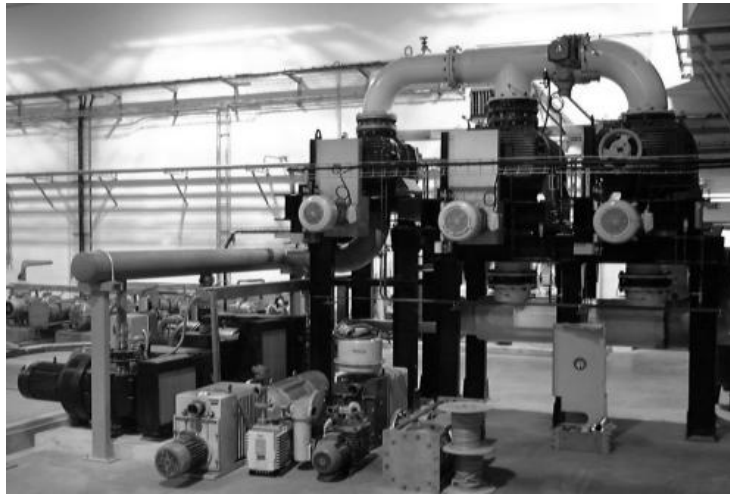
FIG. 3.13 – Groupe de pompage du moyen d'essai
